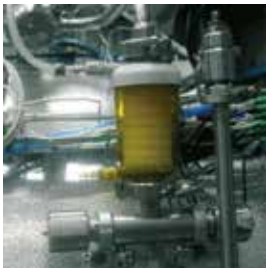
Decontamination of exhaust air with sterile filter / Decontaminazione dell'aria di scarico con filtro sterile
